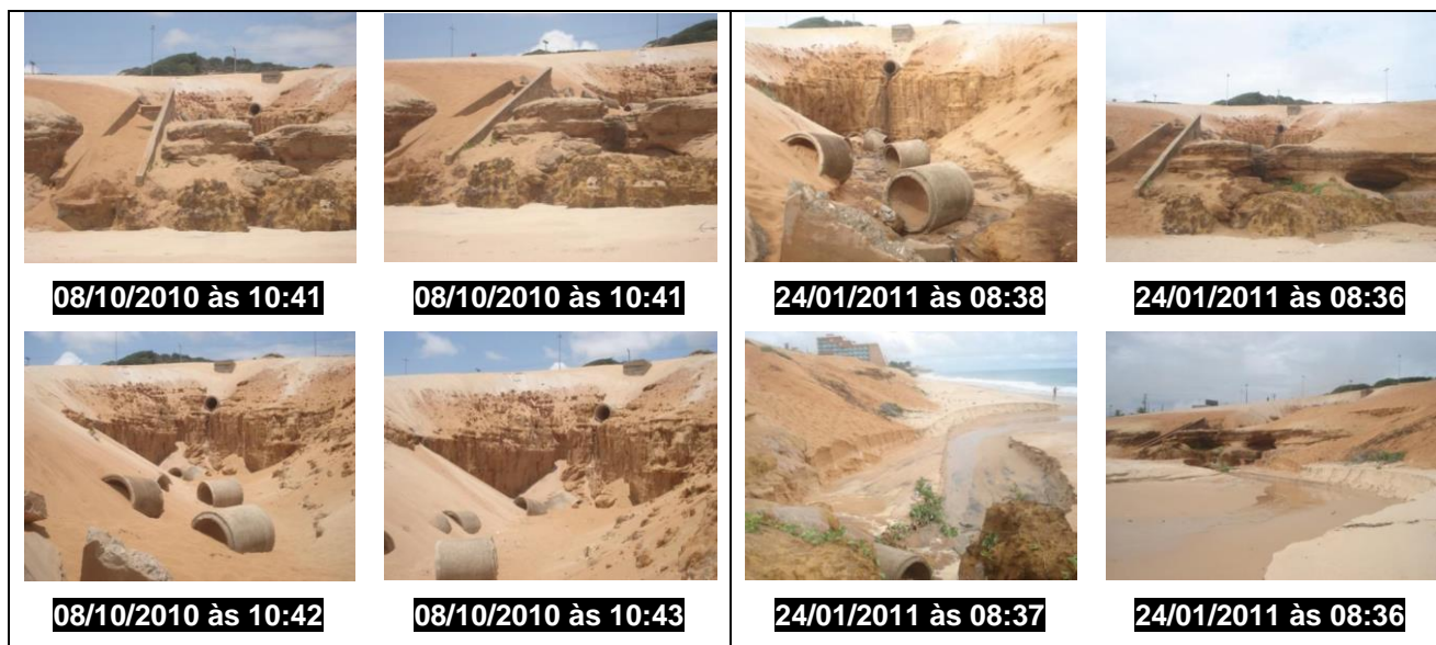
Figura 7 - Sequência de imagens de uma galeria de drenagem pluvial totalmente destruída em duas datas.
