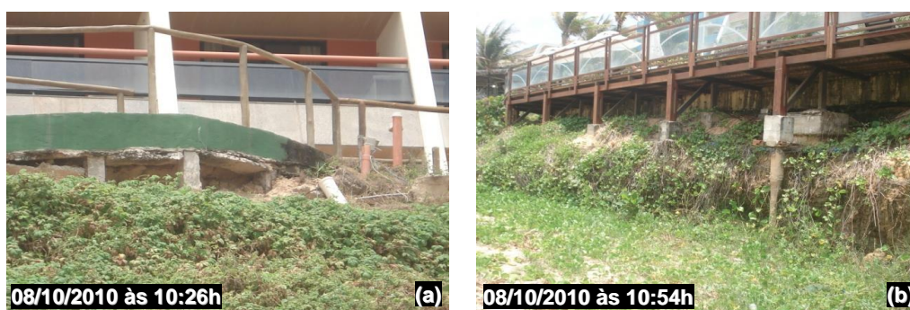
Figura 6 - Figura 5.25: Estruturas expostas as intempéries do ambiente.
