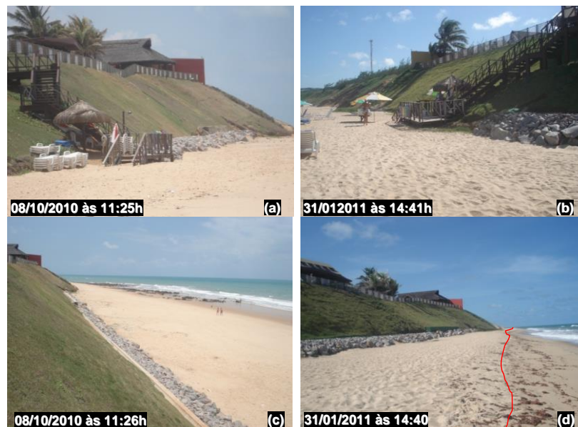
Figura 3 - Vista do Hotel Pestana, em (a), (b) e (c) situação de maré baixa mostrando pontos de fragilidade da construção, medidas de proteção e escada de acesso com estágio inicial de comprometimento; em (d) maré alta demarcada pela linha em vermelho.
